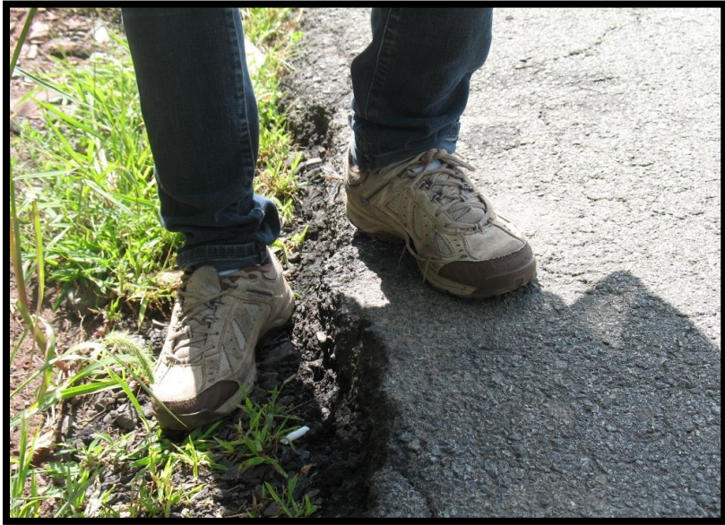
Pavement edge drop off
