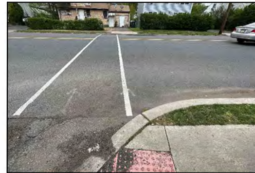
Missing ADA curb ramp
