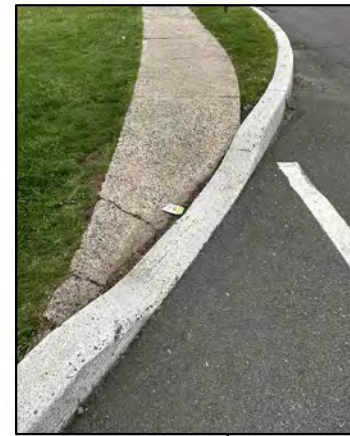
Non compliant ADA curb ramps
