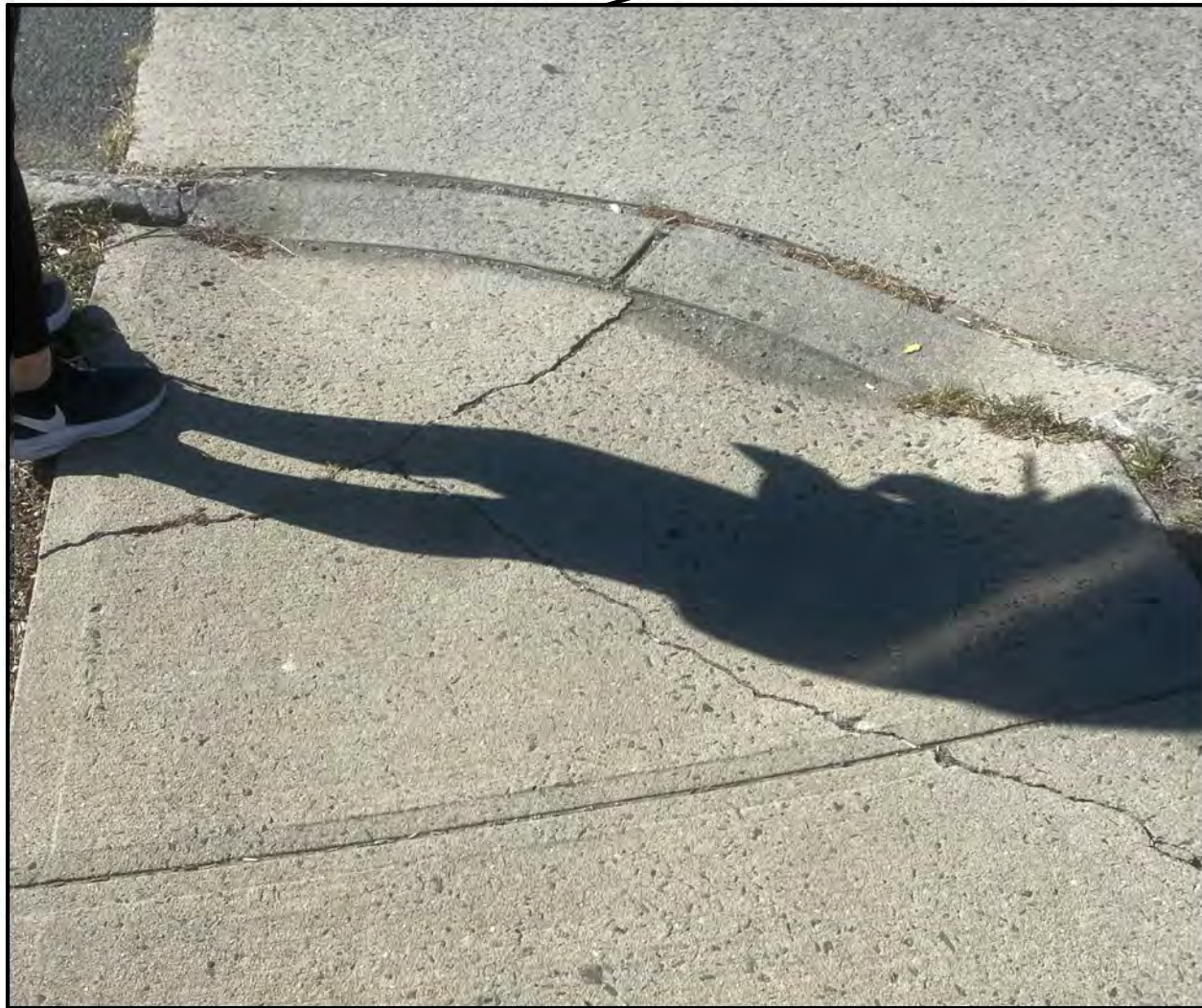
Broken ADA ramp
