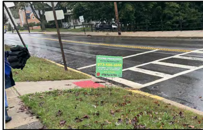
Non ADA compliant curb ramp
