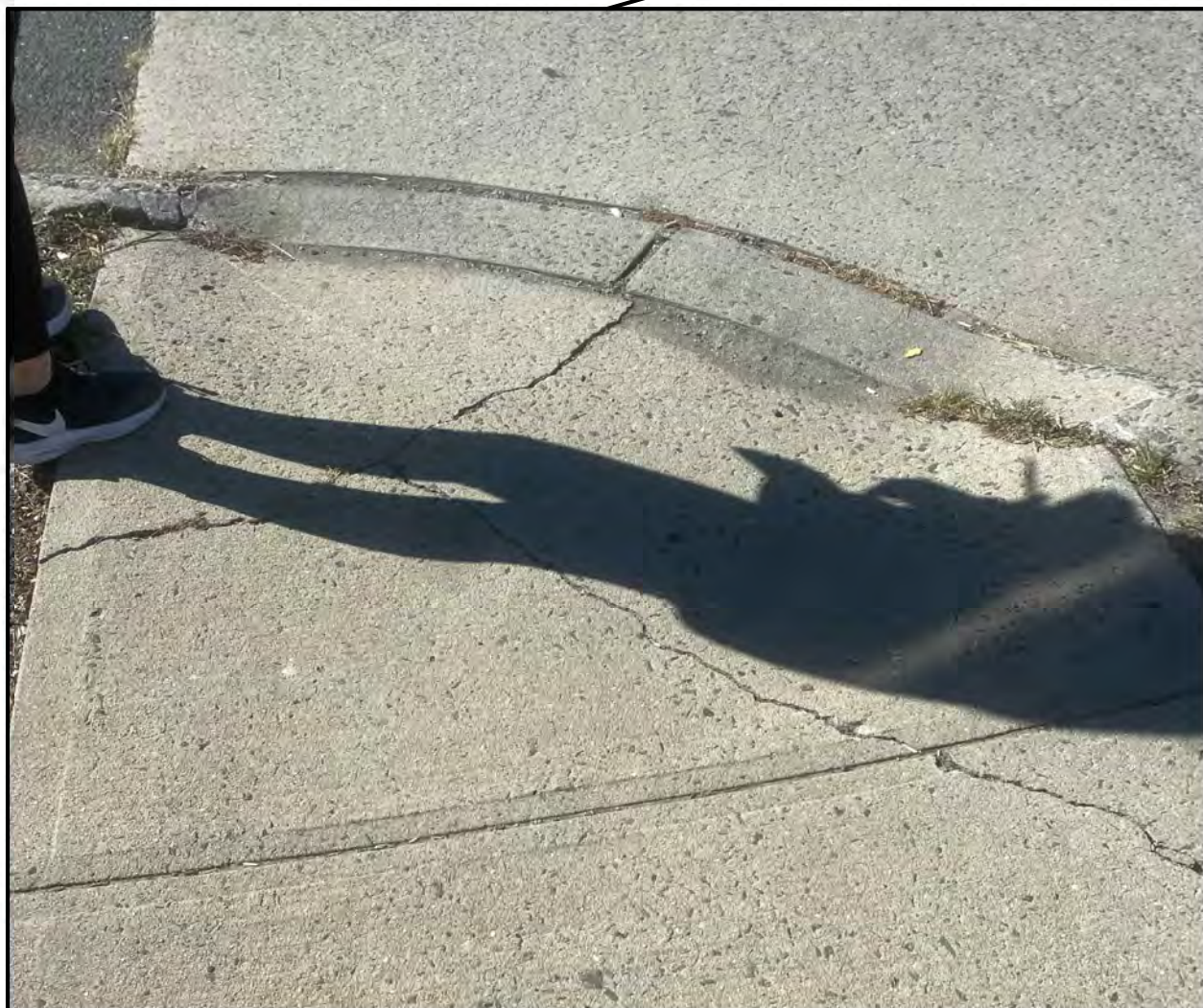
Broken ADA ramp
